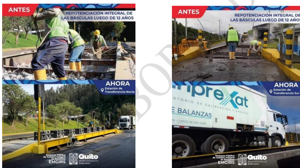
Ilustración 2. Mantenimiento integral de las básculas de pesaje de la ETN y ETS
